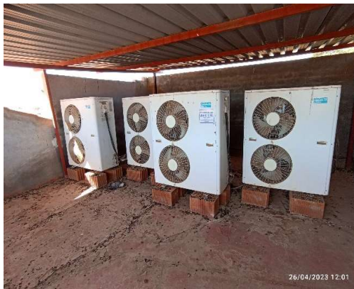
Unidades exteriores bomba de calor en cobertizo bajo cubierta
